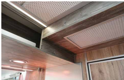
Raumklimatisierung mit Lochdecke
