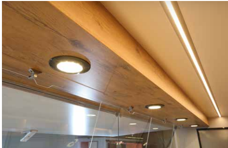
LED-Spots und eingearbeitetes LED-Lichtband
